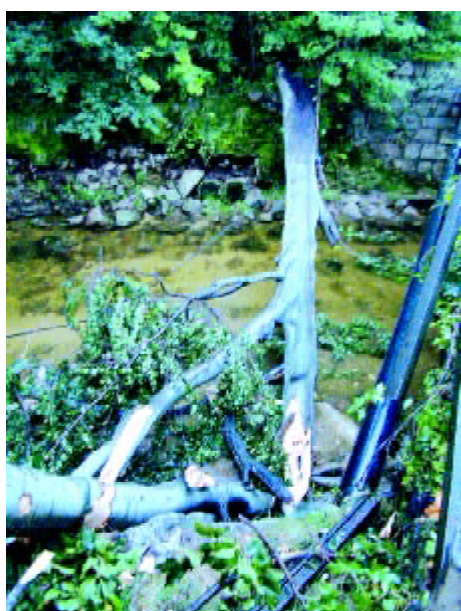
Spadające do Kwisy drzewo zniszczyło barierkę.
