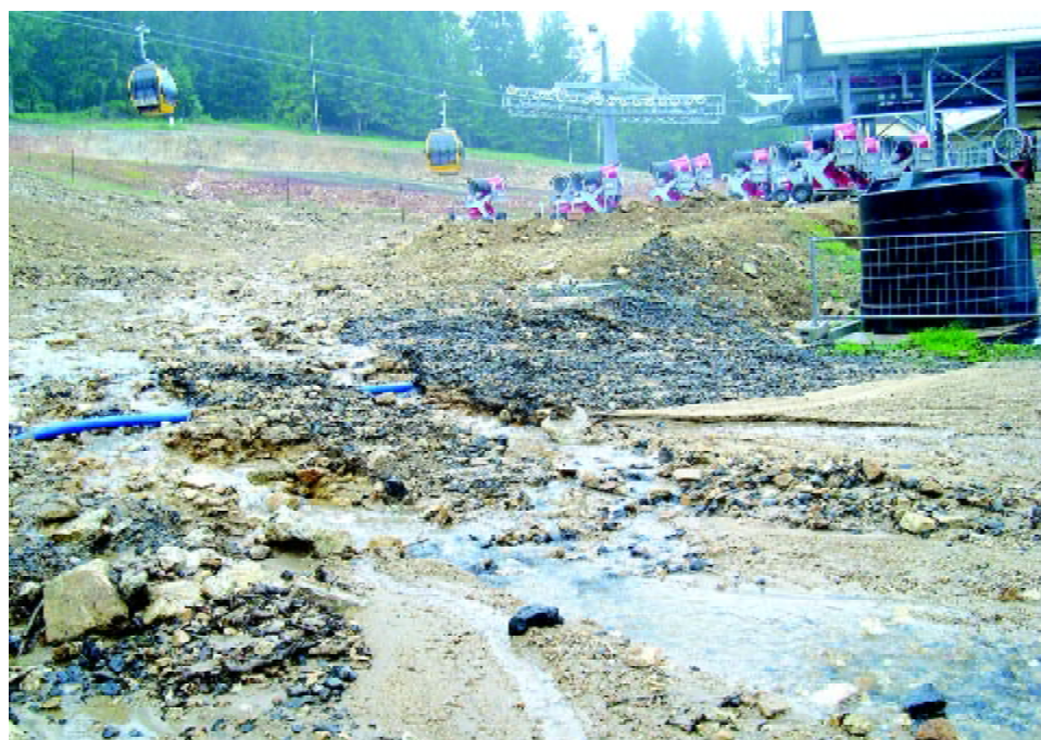
U góry nurt powodziowej rzeki na dolnej stacji, gdzie woda odsłoniła rury i poniosła w dół zwalę ziemi.
