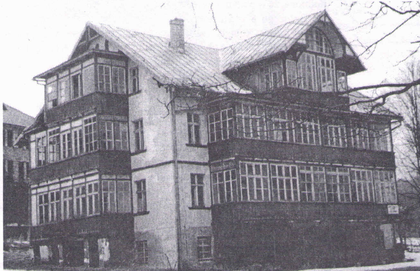
„Jerzy” od 10 lat stoi pusty - nie zarabia (mimo to wciąż trzeba zań płacić podatki), nie remontowany, nawet nie konserwowany. Spółka niewiele uzyska ze sprzedaży, bo nabywcę odstraszą wysokie koszty modernizacji.
