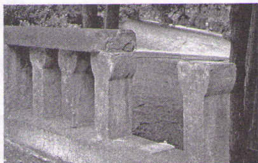
Stuletnia solidna kamienna balustrada nie zdołała oprzeć się niszczycielskiej sile wandalów
