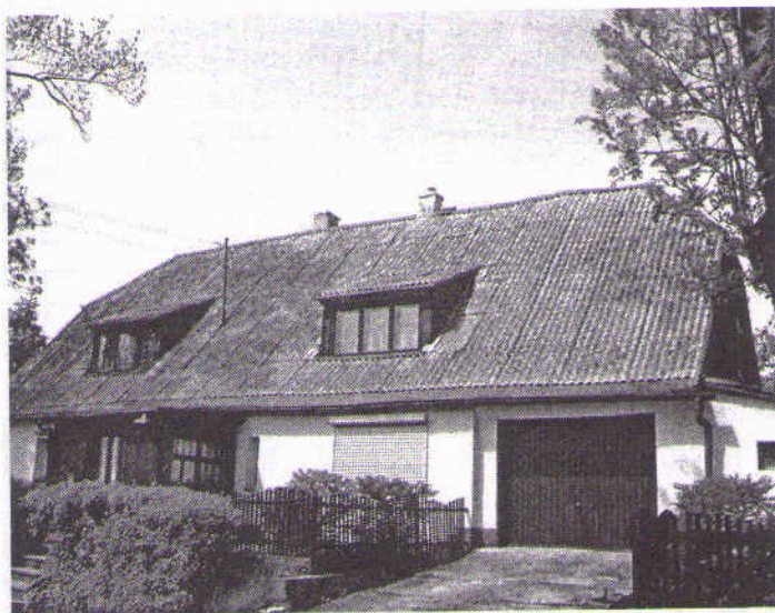
W samej tylko Czerniawie kilkadziesiąt domów ma dachy pokryte eternitem
