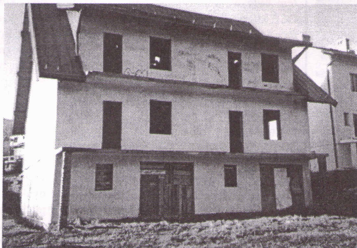
Częsta zmiana inwestorów domków przy ul. Nad Basenem sprawia, iż na niektórych budowach straszą puste oczodoły okien.
