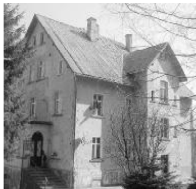
Muszą się znaleźć pieniądze na wymianę azbestowego dachu domu przy ul. Prusa 1
