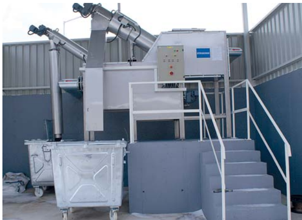
Zintegrowane urządzenia do mechanicznego oczyszczania ścieków. Poniżej - pomieszczenie z dmuchawami.
